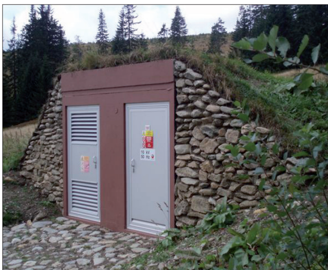
Klínové boudy v Krkonoších. Distribuční transformátorová stanice 35 kV, 630 kV·A pro více odběratelů na straně nn. Buňka je zapuštěna do terénu, proto má zesílené stěny a střechu s atikou, aby ji bylo možné zahrnout hlínou. Těchto stanic je v Krkonoších několik, využívá je ČEZ.
