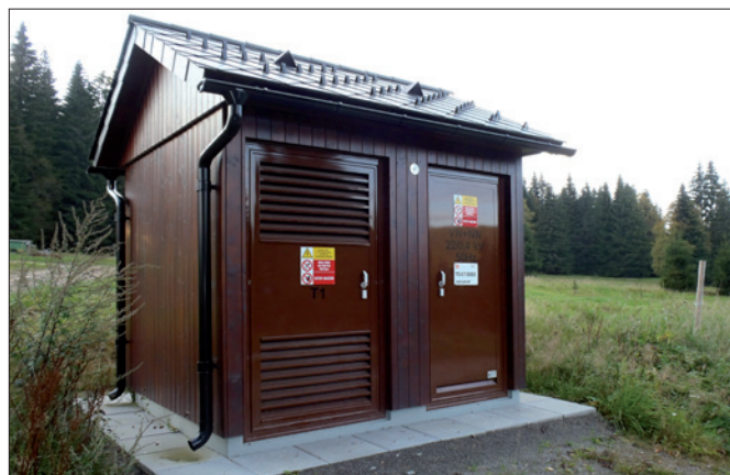
Obec Modrava na Šumavě má po přenesení vzdušného vedení pod zem šest distribučních transformátorových stanic. Ta na snímku obsahuje transformátor 22 kV, 630 kV·A, v rozváděčové sekci je vn rozváděč a osmivývodový nn rozváděč. Ke stanici je připojeno několik odběratelů. Sedlová střecha stanice je podle návrhu architekta.
