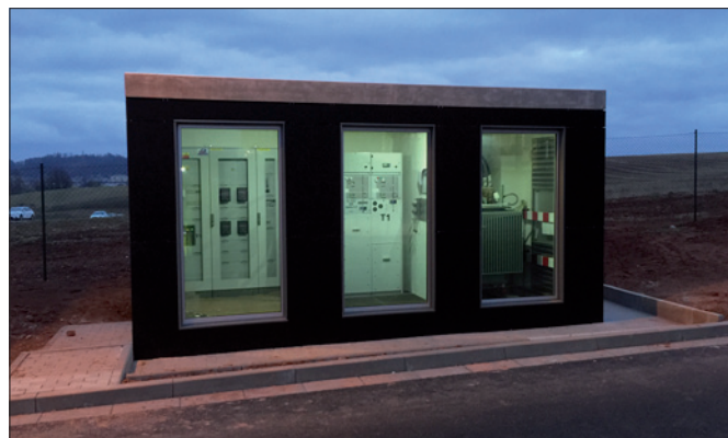
Distribuční transformátorová stanice 35 kV, 630 kV·A pro nově budovaný průmyslový areál v Podkrkonoší. Je určena pro jednoho odběratele. Prosklení 2×4 mm, bezpečnostní sklo.
