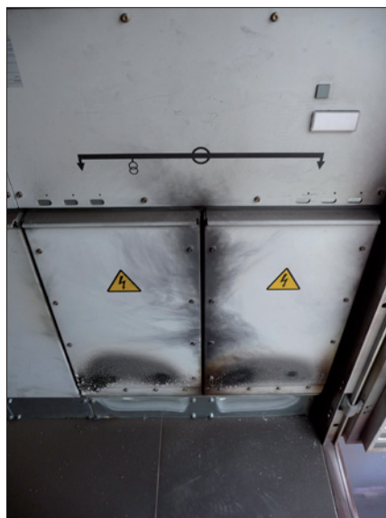
Obr. 5. Pohled na čelní stěnu rozváděče vn (pole měření) po zkoušce obloukovým zkratem. Dveře odolaly tepelným a tlakovým účinkům oblouku
