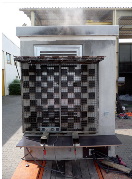
Obr. 6. Blokovaná transformovna po zkoušce, která ověřila její bezpečnost pro veřejnost. Všechny dveře, víka a poklopy zůstaly zavřené
