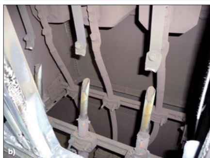
Obr. 3. Zkouška obloukovým zkratem v rozváděči VN (pole měření) a) uspořádání před zkouškou (iniciační drátek spojuje fázové přívoody), b) vnitřek rozváděčového pole po zkoušce
