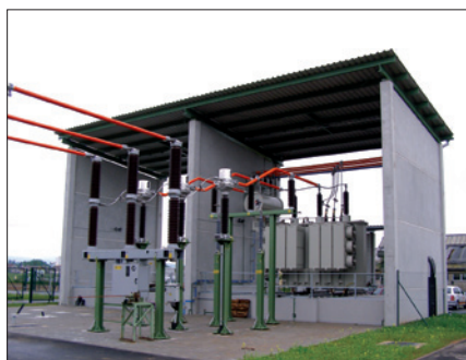
Obr. 3. Zastřešené trafostání Mnichovo Hradiště
