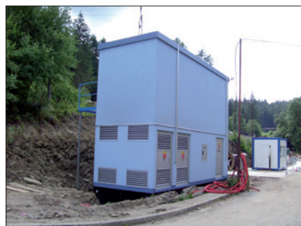
Obr. 2. Dvoupodlažní trafostanice Vsetín II 2x 1 000 kVA
