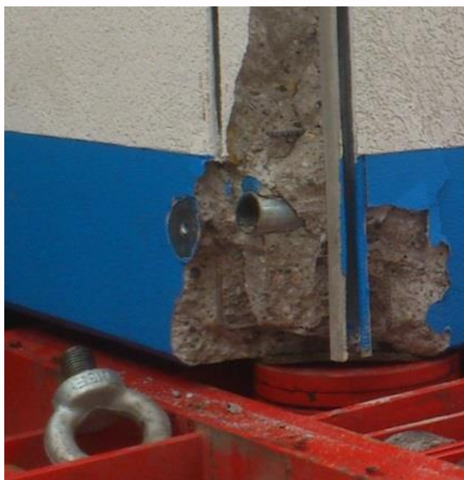
Obr. 8: Deformace způsobená nedovoleným způsobem zdvihání
