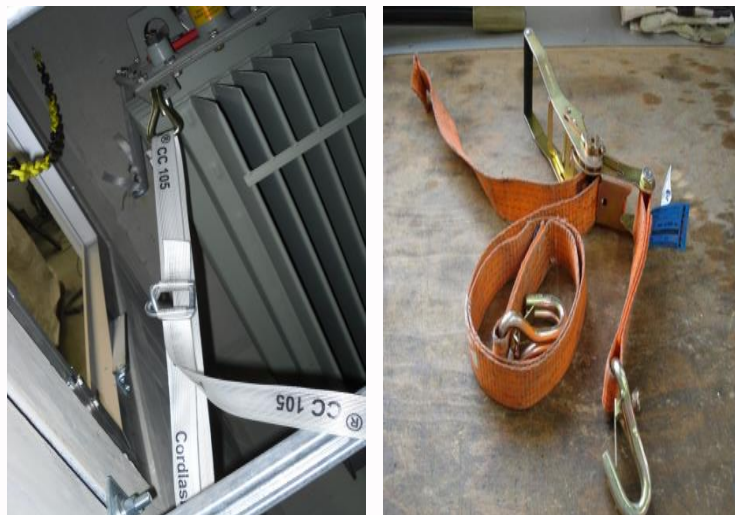
Obr. 17: Příklady zajištění transformátoru v trafostanici
